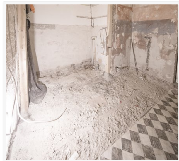
Uit de praktijk: een oneffen vloer na verwijdering van tegels.
